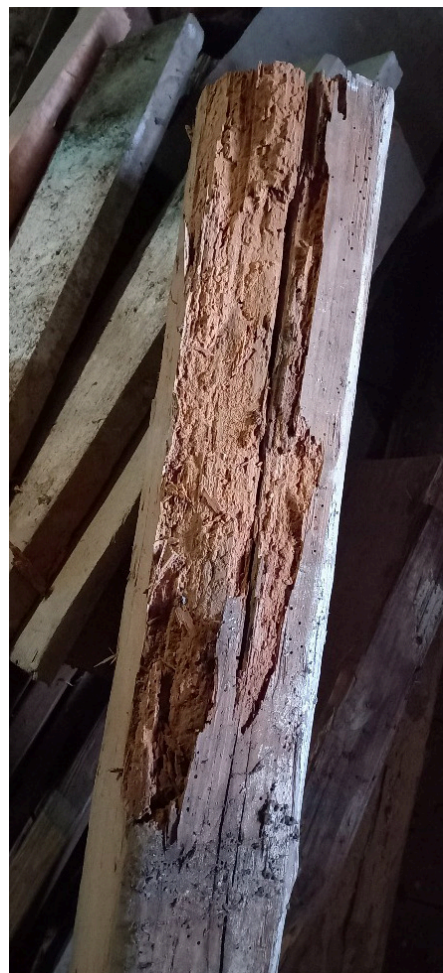
▲ Zdegradowany kornikami tramek podtrzymujący podestę pod dzwonami
